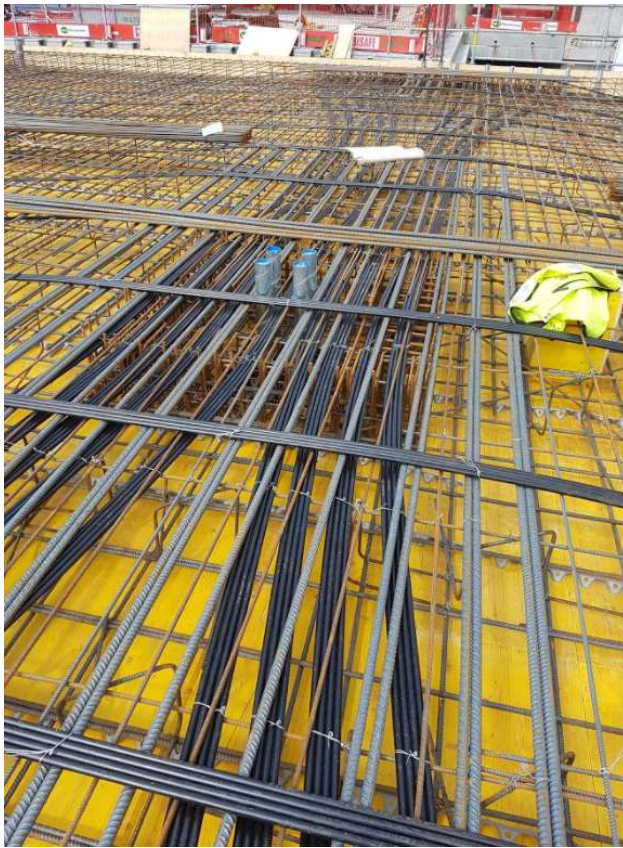
Kuva 18. Rasvapunosten suojaputkia. (Pulliainen 2017)
