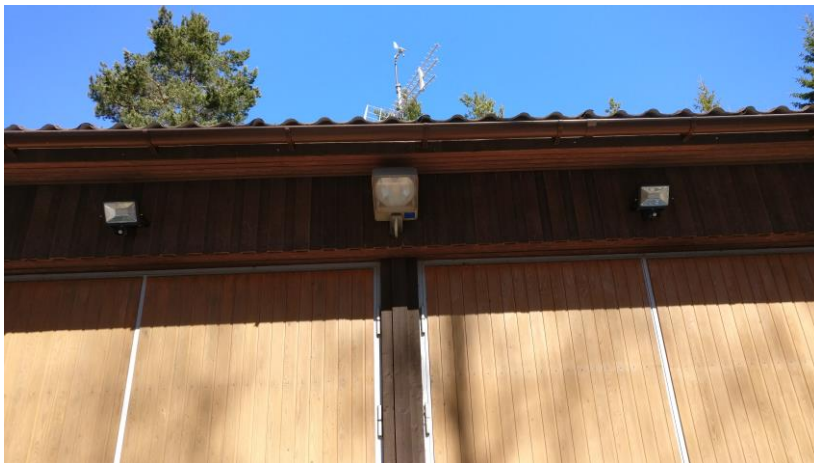
Kuva 26. Autotallin ovien päälle asennetut LED-valaisimet. Keskellä vanha 125 W:n valonheitin.
