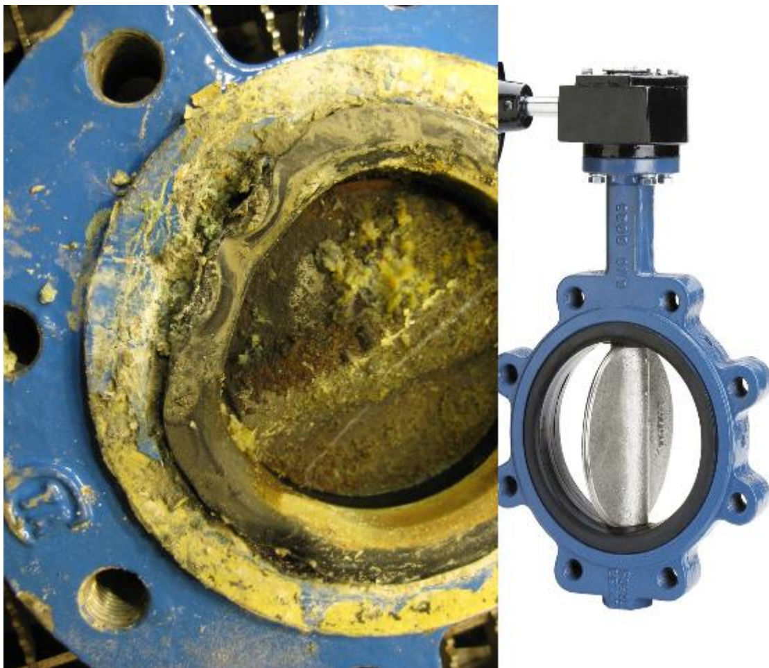
Kuva 8. Rakokorroosio venttiilirungossa.(Tanttu s.a.)
