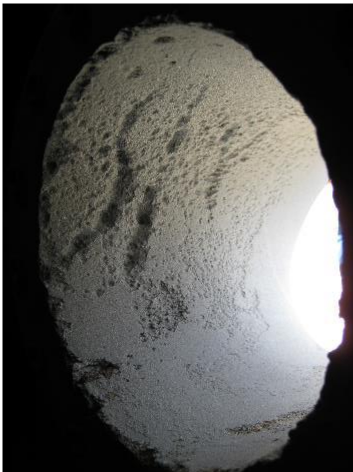
Kuva 6. Piste-, rako- ja kemiallisen korroosion yhteisvaikutus pakoputken laitaläpiviennissä.(Tanttu s.a.)
