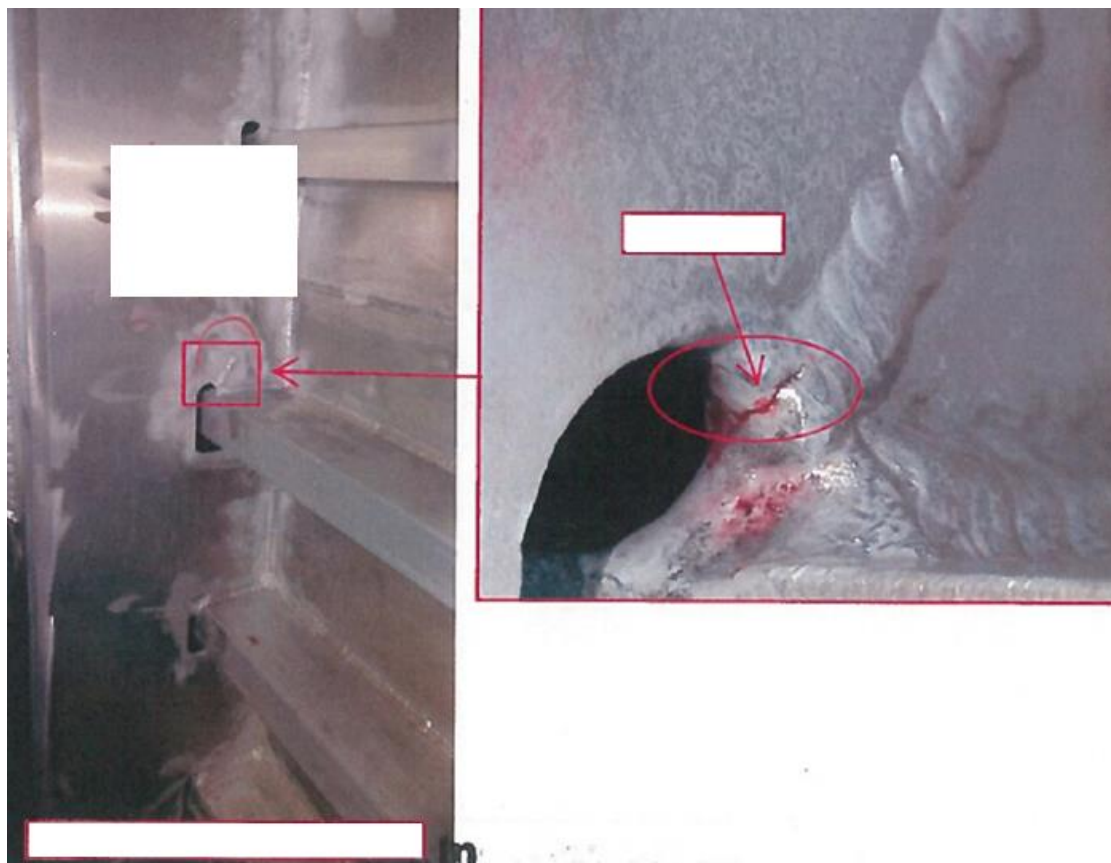
Kuva 9. Tunkeumaväritarkastuksessa paljastunut murtuma kaaren ja pitkittäisjäykkääjän hitssaussaumassa. (Merivoimat s.a.)
