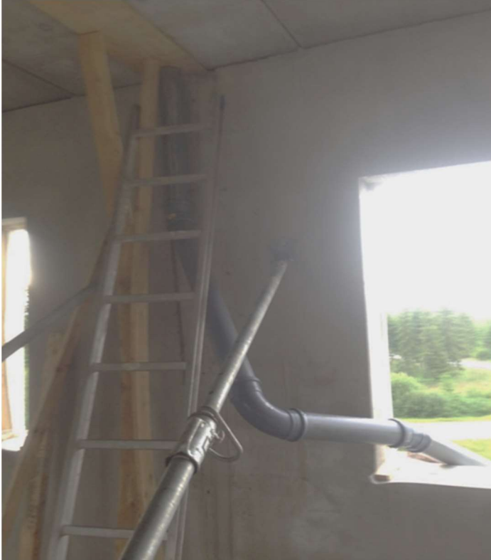
KUVA 6. Väliaikainen sadeveden poistojärjestelmä (19.)
