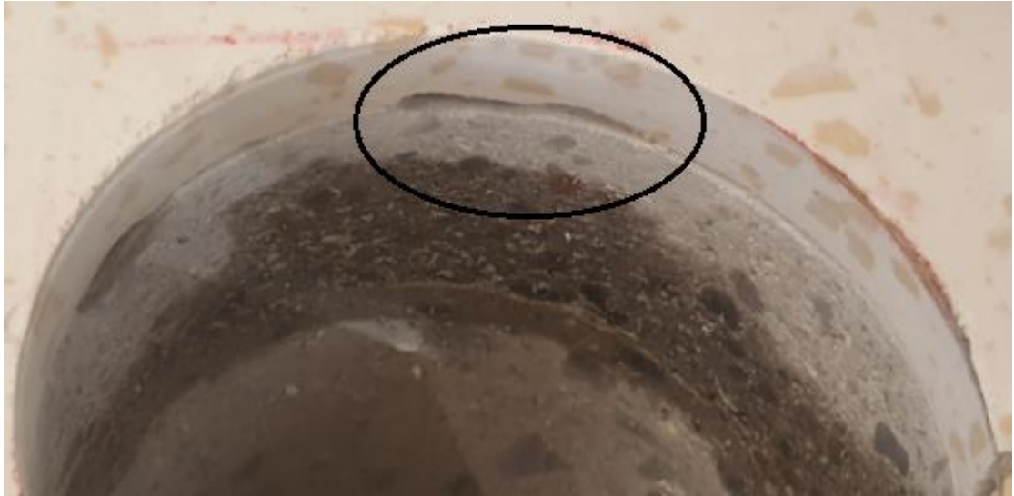
Kuva 14. Ilmatasku laatan ja liima-aineen välissä
