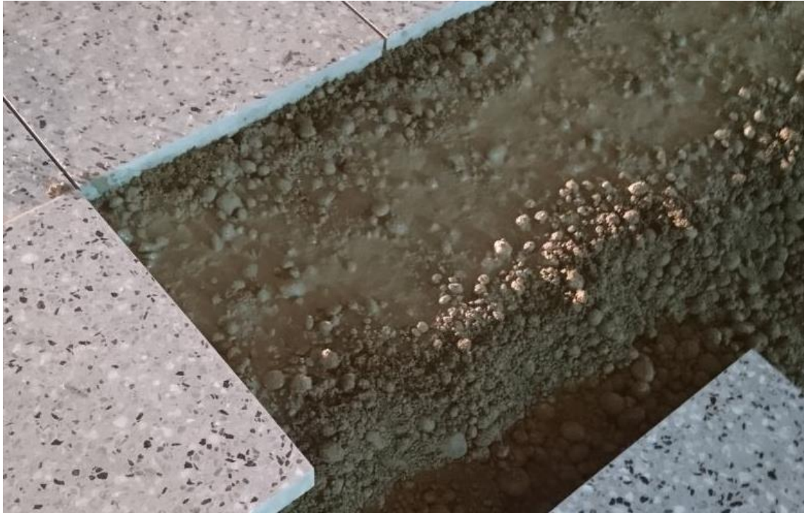
Kuva 1. Palloutunut maakostea betoni
