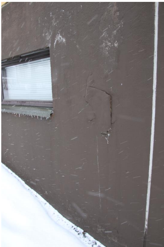
KUVA 5. Alimman kerroksen betonielementin pinnan rikkoutumista
