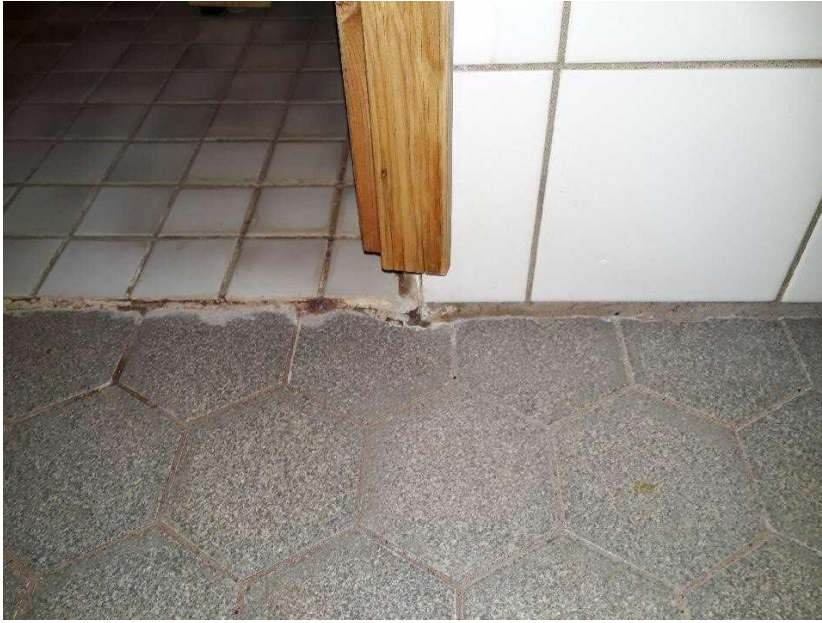
KUVA 7. Saunan ja kylpyhuoneen välinen lattiasauma. (Kuva: Jouni Kononow)
