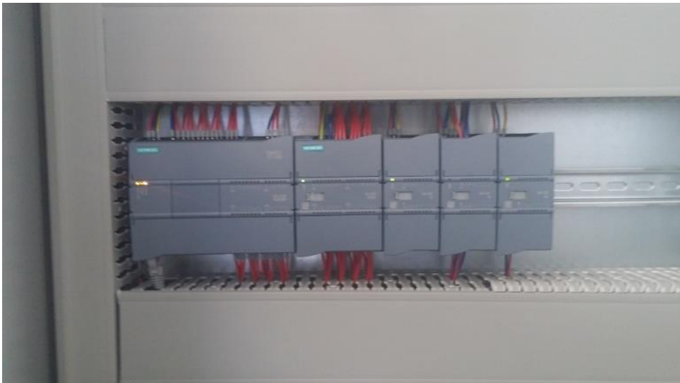
KUVA 18. S7-1200-logiikka, digitaalisten liitântöjen laajennuskortti ja kolme analogisten liitântöjen laajennuskorttia
