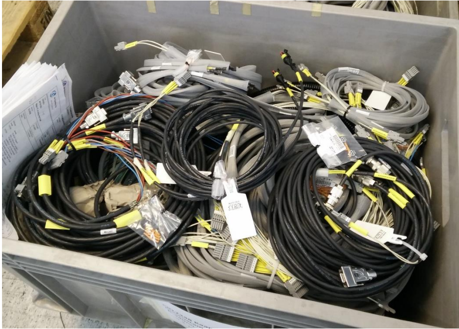
KUVA 9. Johdinsarjoja ja valmiskaapeleita liittimillä
