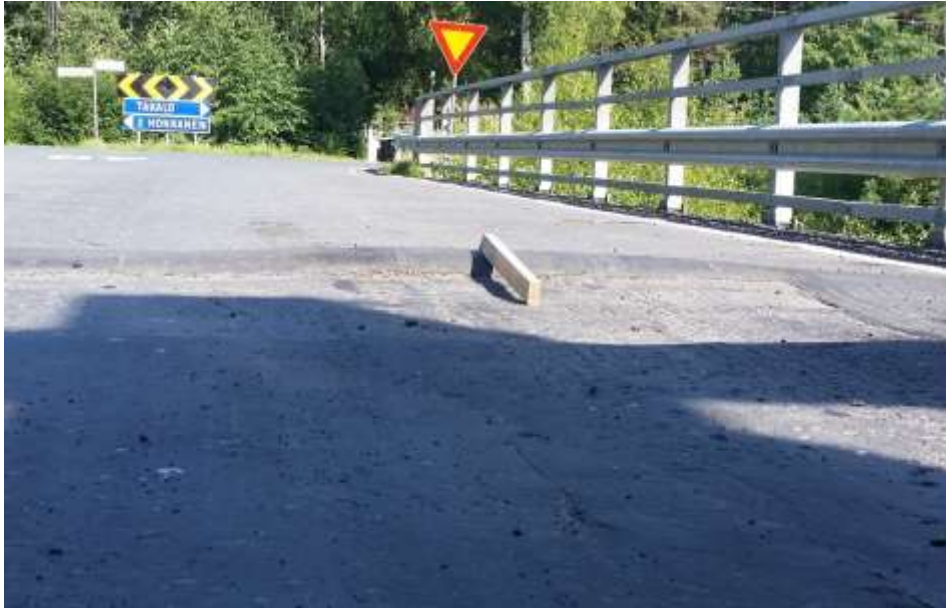
KUVA 5. Lämmön vaikutuksesta kohonnut liikuntasauma sillan päässä
