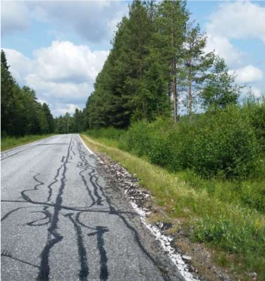
KUVA 6. Liian ohut rakennekerros tien reunassa
