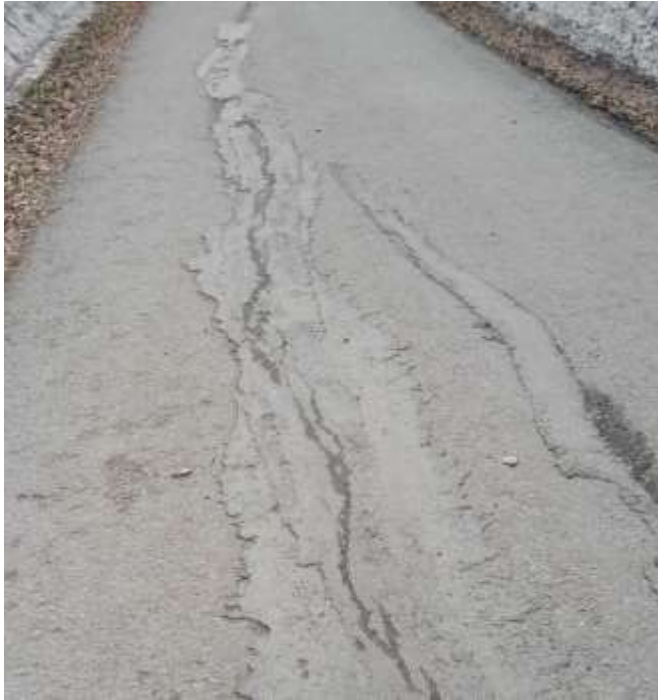
KUVA 4. Pituushalkeama kevyenliikenteen väylällä
