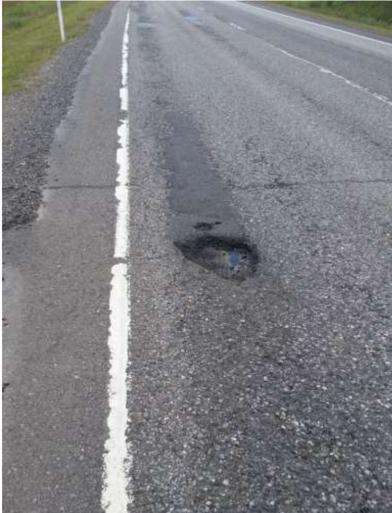
KUVA 3. Kertaalleen paikattu reikä päällysteessä
