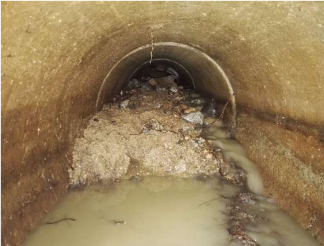
KUVA 4. Jakavan kerroksen materiaalia rummussa
