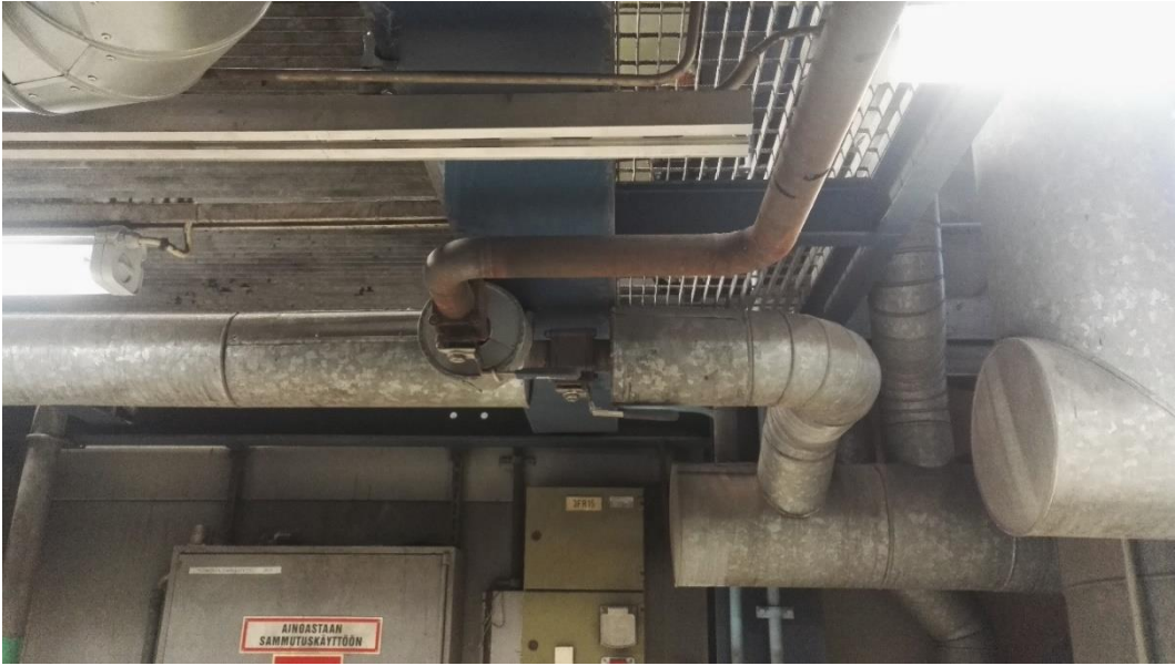
Kuva 5. Yksikön So3 jatkuvan ulospuhalluksen ja pohjapuhalluksen putkien liitoskohta
