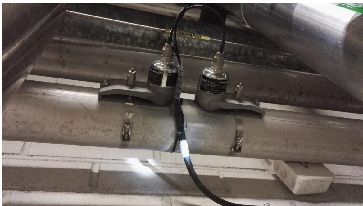
Kuva 3. Ultraäänivirtausmittari (1UZ70F001) kaukolämmön II pehmentimelle
