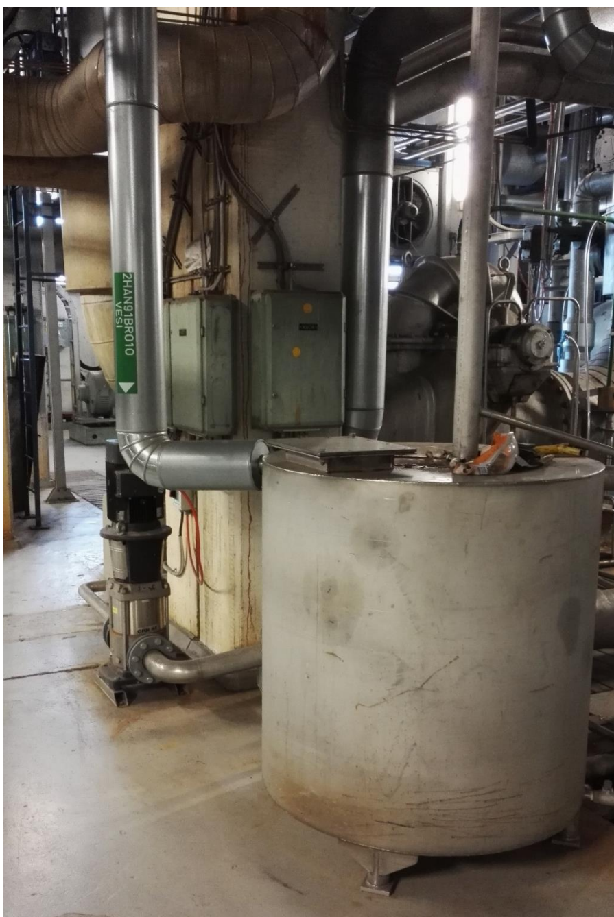
Kuva 4. Yksikön So2 jatkuvan ulospuhalluksen säiliö II
