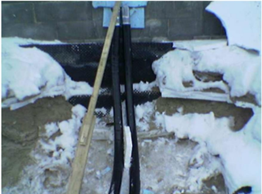
Kuva 1. Maanpinnan yläpuolelle nostettu joustava kaukolämpöelementti. (Jyväskylän Energia n.d.)
