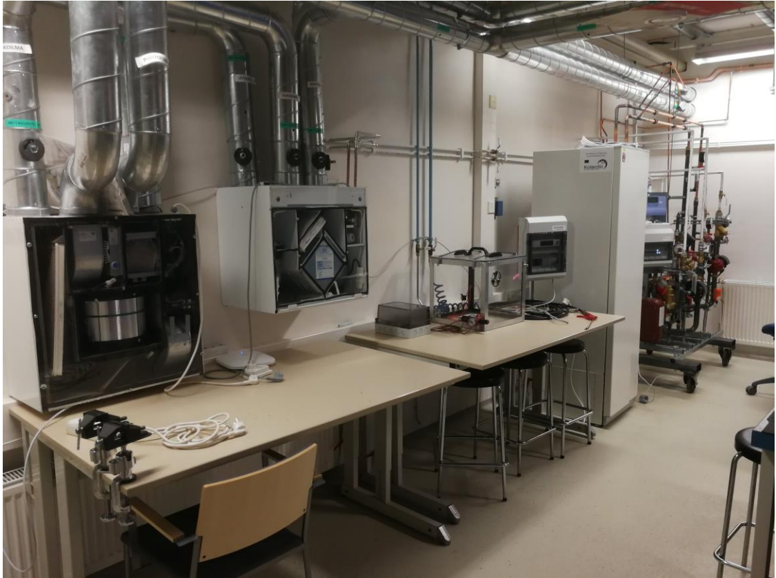
Kuvio 38. Lapin AMK Rovaniemen toimipisteen talotekniikan laboratorion harjoitus-IV-kojeistoja ja lämmönvaihdinpaketti säätimiseen [4].
