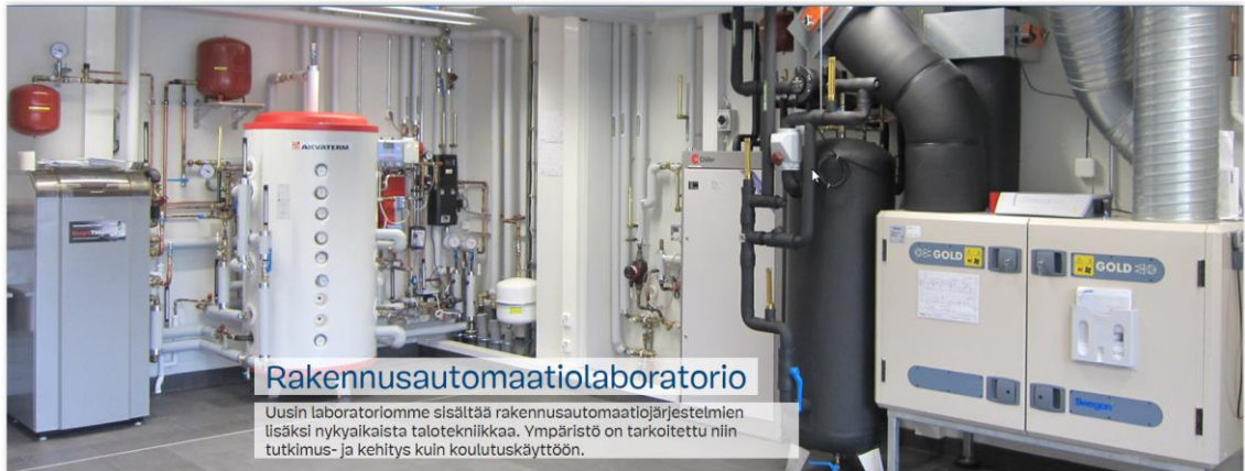
Kuvio 31. Uudistettu rakennusautomaatiolaboratorio (JAMK) [48].
