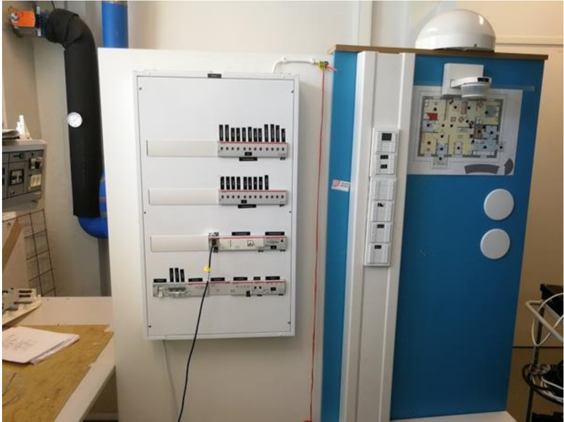
Kuvio 40. REDU koulutuskeskuksen Jokiväylän toimipisteessä sijaitseva sähköisen talotekniikan KNX-opetuslaitteisto [4].
