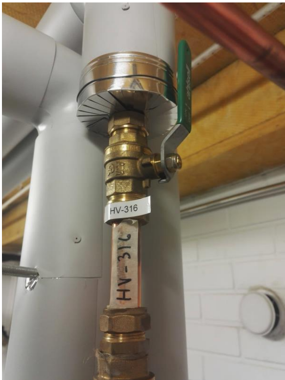
Kuva 7. Käsiventtiili HV-316 Auki-asennossa.
