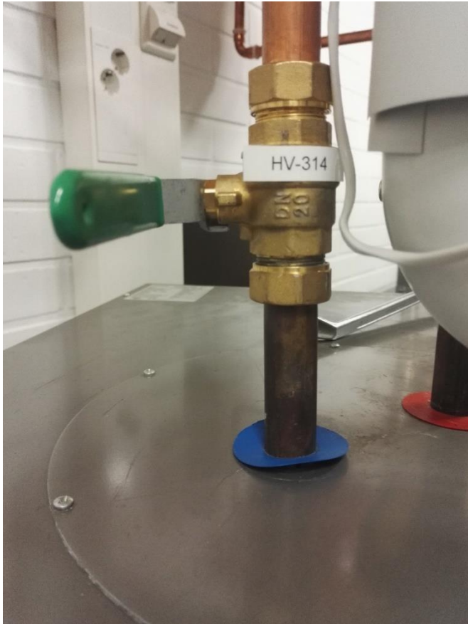
Kuva 6. Käsiventtiili HV-314 kiinni-asennossa.
