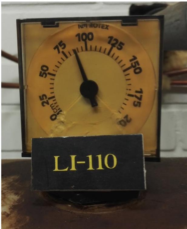
Kuva 1. Pinnanmittauksen LI-110 positiokyltti öljysäiliössä.
