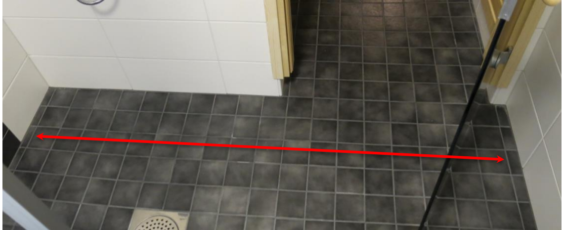
Kuva 11. Esimerkki virheellisestä mitoituksesta. Molemmissa reunoissa alle puolikas laatan leveys. (YIT Rakennus Oy 2015).
