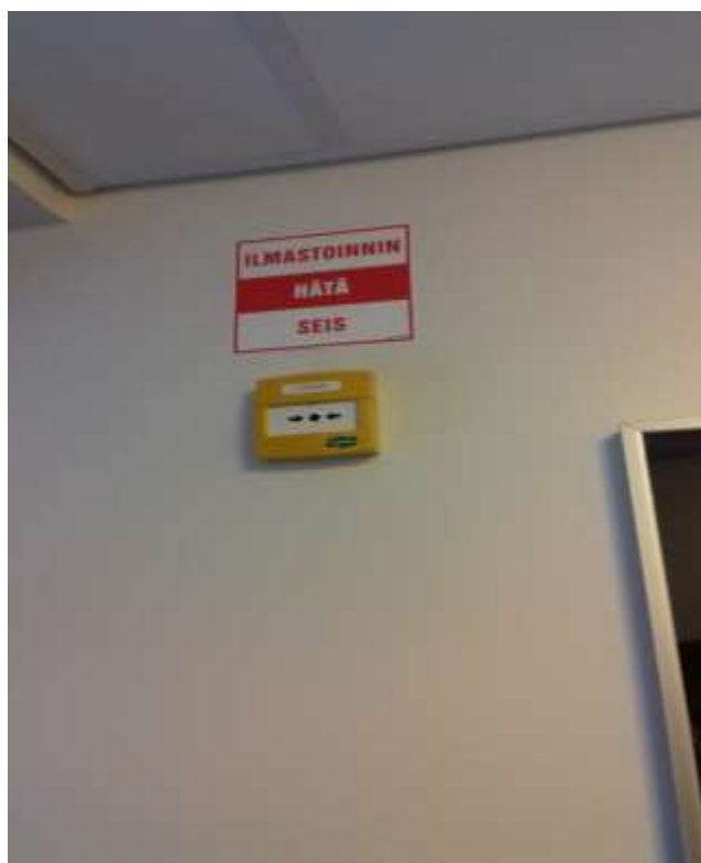
Kuva 4. Esimerkkikohteen ilmastoinnin pysäytyspainike.
