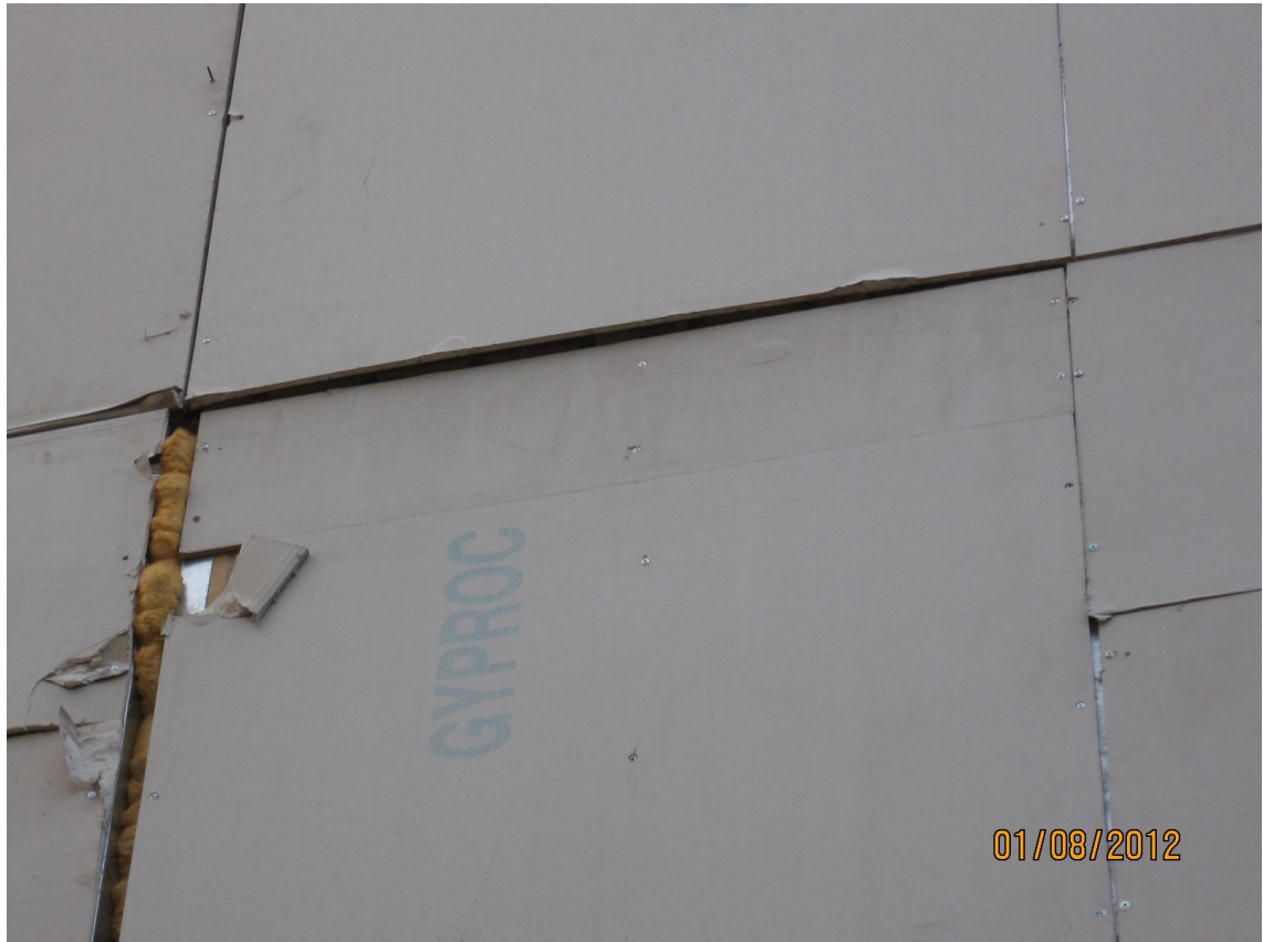
KUVA 10. Julkisivuelementin vaurioita ja mittatarkkuuden poikkeamia. (Skanska Talonrakennus Oy)
