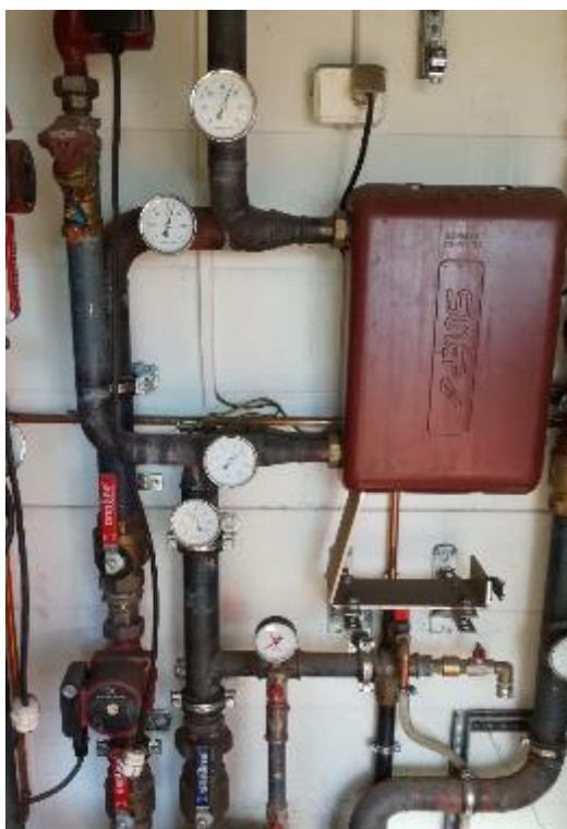
KUVA 4. Levylämmönvaihdin asennettuna (Perälä, 2018.)
