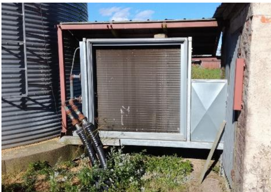
KUVA 1. Viljan-kuivurin ottoilmaa lämmittävä radiaattori. Uuni sijaitsee oikealla. (Perälä, 2018)
