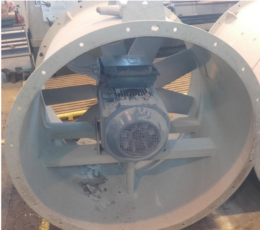
Kuva 3. Huoltoa odottava kaivoksen ilmanvaihtopuhallin.
