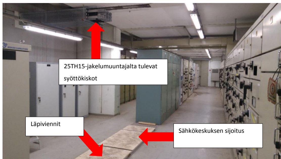
Kuvio 37. Prosessisähkökeskus, 12ST52-sähkötila
