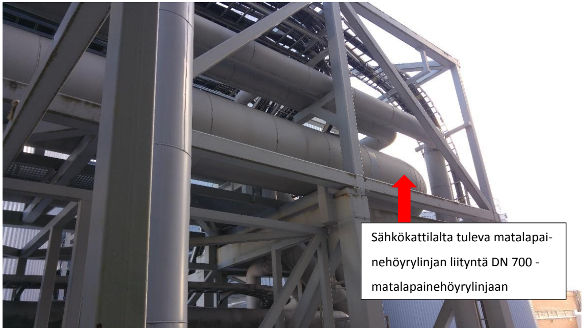
Kuvio 42. Liityntä putkisillan matalapainehöyrylinjaan
