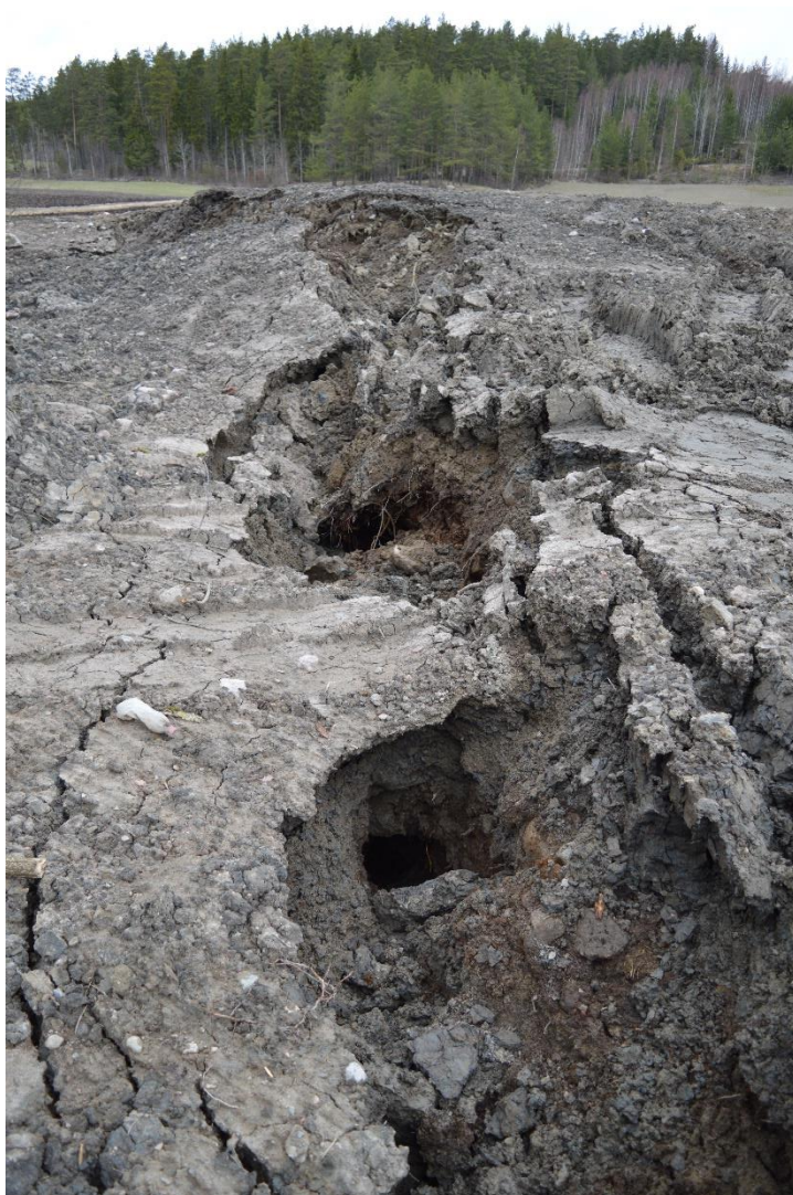
Kuva 36. Penkan päälle painoa tuoneet massa ovat aiheuttaneet savimassojen sortumista ja maannousua kaatopaikan alueella
