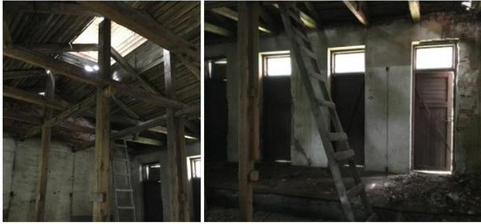
Kuva 24. Kuvat rakennuksen sisältä, jossa vasemmalla puupilarit ja palkit. Oikealla mitatut ovet ja epätasainen lattia.
