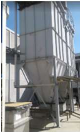
Kuva 13. 8-hallin pölynpoistojärjestelmän imuri.
