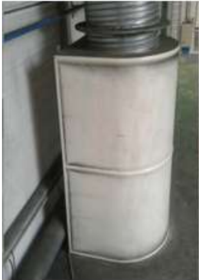
Kuva 12. 8-hallin tuloilman päätelaite.
