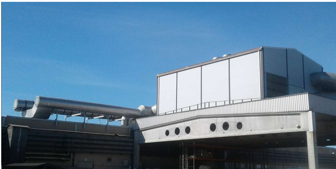
Kuva 7. 2-hallin konehuone sijaitsee katolla.
