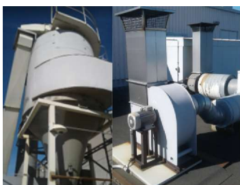
Kuva 5. Keskusjärjestelmän imuri sekä yksittäisjärjestelmän huippuimuri.
