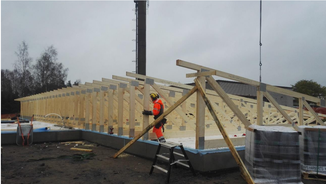
KUVA 10. Kattoristikot on kätevä koota maajalassa elementeiksi, sekä laadun että työturvun kannalta. Lehto Group, Esperi Care, Haapajärvi. (22, Kuva: Lauri Österberg)
