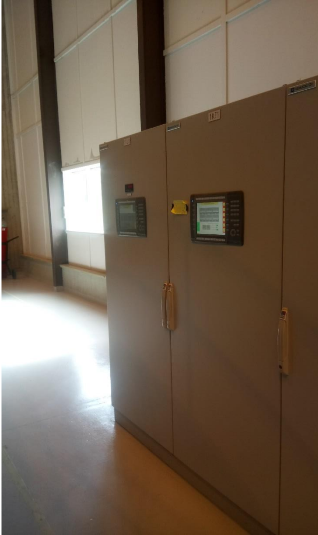
KUVA 6. Koneisto 1:n konesalin operointipäätteet.
