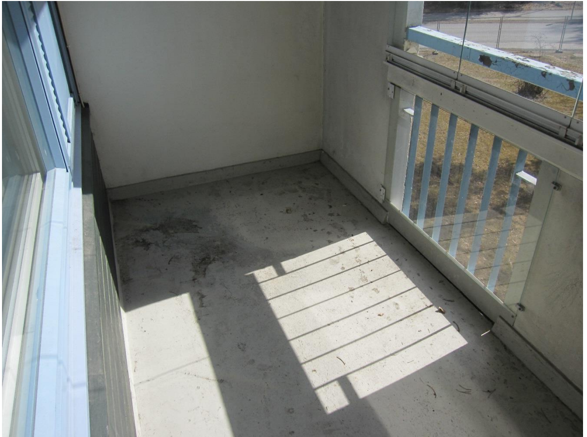
Kuvio 7. Parvekkeen sisäpinta ennen korjausta. Näkyviä vaurioita betonilaatassa sekä kaiteessa.
