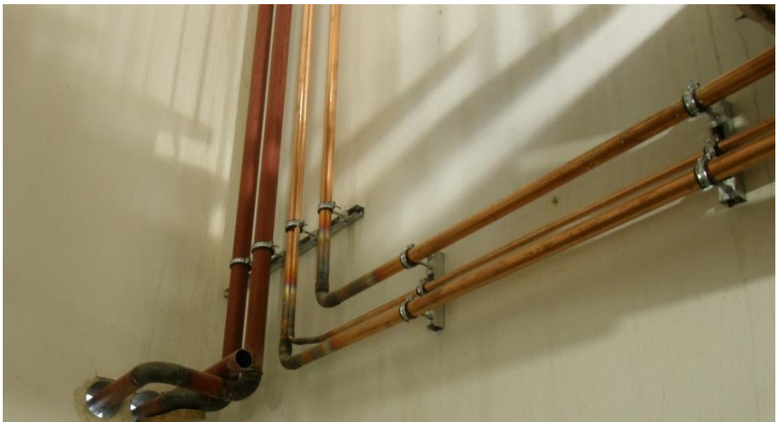
Kuvio 3. Putkiviennit käytävässä. Lämmitysputket ja käyttövesiputket.
