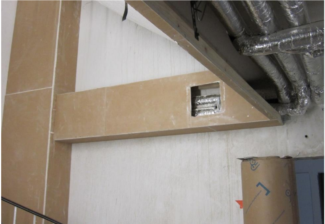
Kuvio 4. Käytävän putket eristettynä ja koteloituna.
