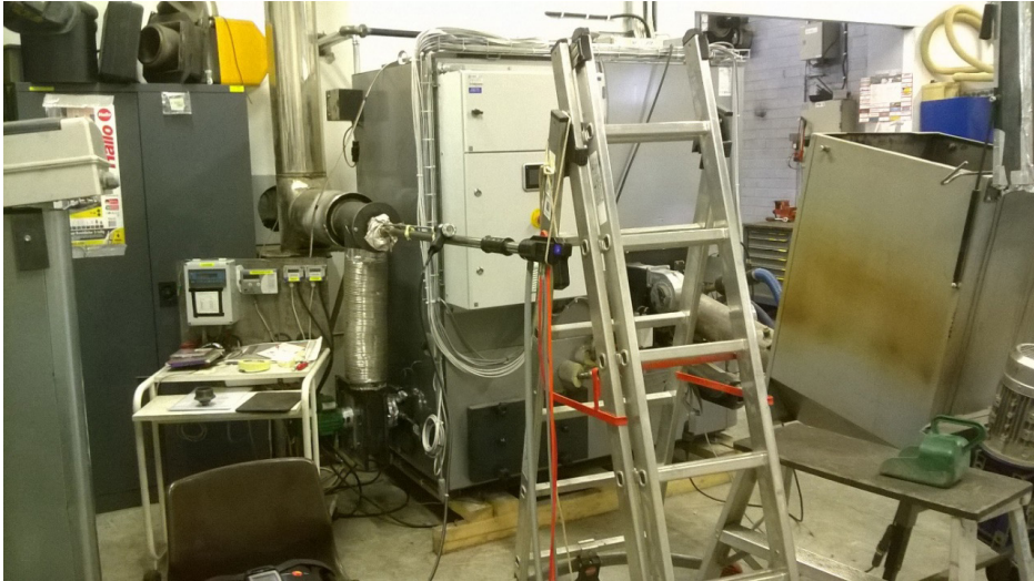
KUVA 6. Testo 350 -savukaasuanturi ja Dr. Födisch -hiukkasmittausanturi savukaasukanavassa (kuva Tarja Seppänen).
