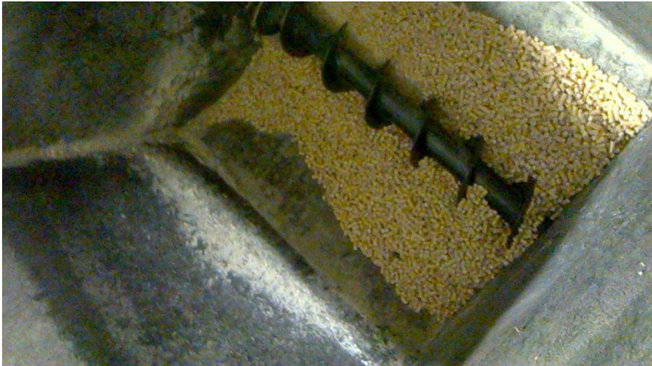
KUVA 2. Polttoaineen syöttö ruuvilla kattilaan (kuva Tarja Seppänen).
