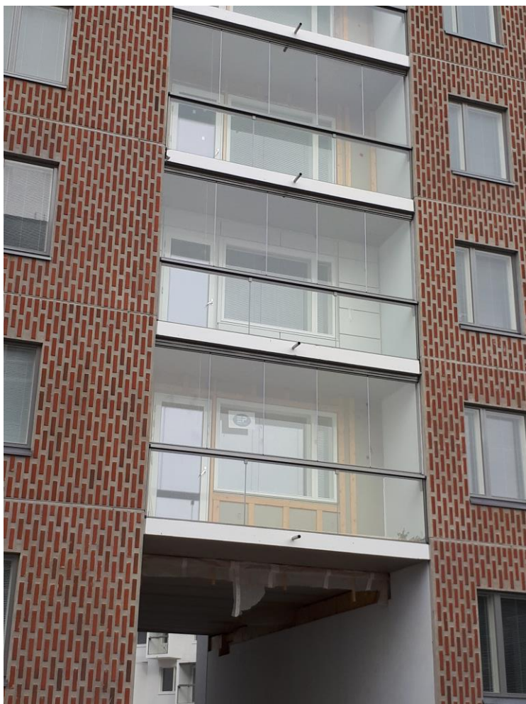
Kuva 13. Lasitukset ja kaiteet ovat suuria riskikohtia parvekkeissa. Niiden asennukseen tulee kiinnittää huomiota.
