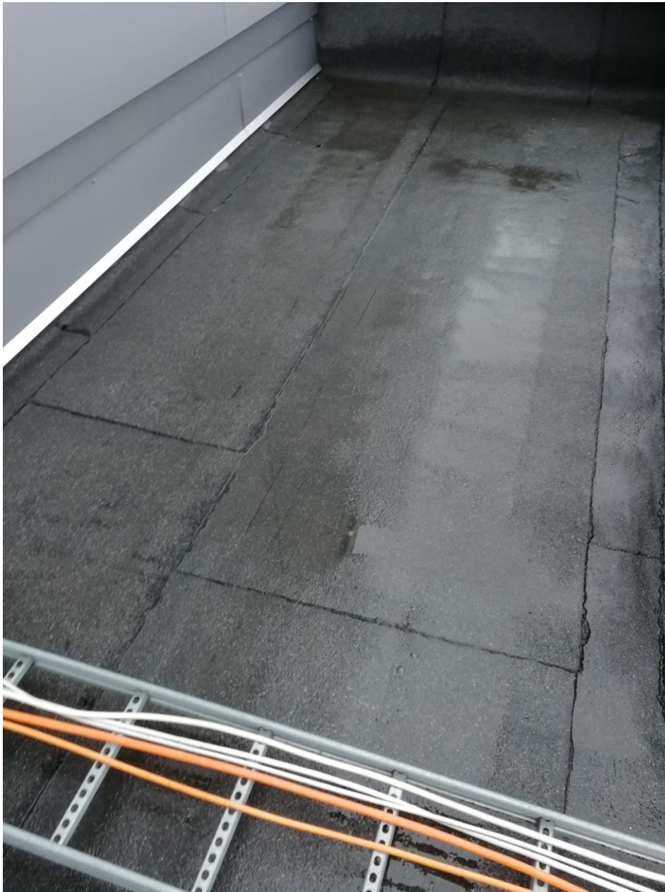
Kuva 17. Vesi lammikoituneena katolla, syynä oli vesikaton kaltevuuden puutteellisuus.
