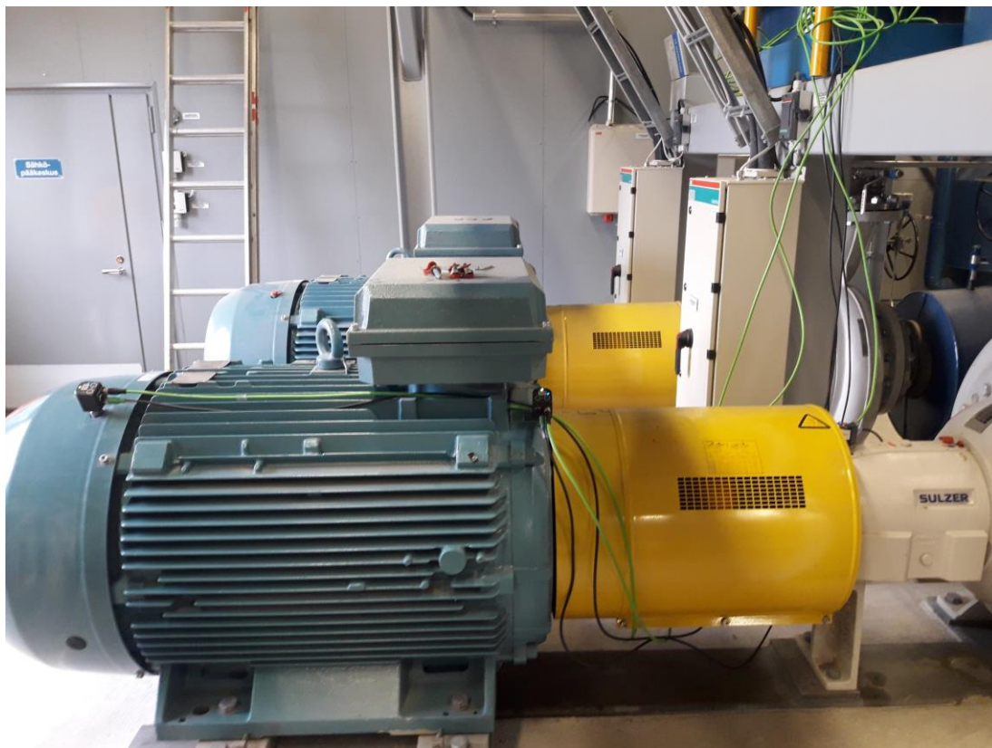
Kuva 14. Etäkunnonvalvonta järjestelmä käyttövalmiina (Kuva: Jaakko Manninen 2018)
