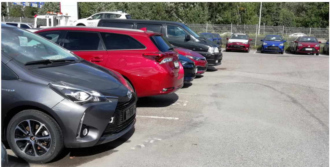
Kuva 10. Takapysäköintialueen paikkamerkinnät, jotka ovat haalistuneet osalta paikoista lähes kokonaan.
