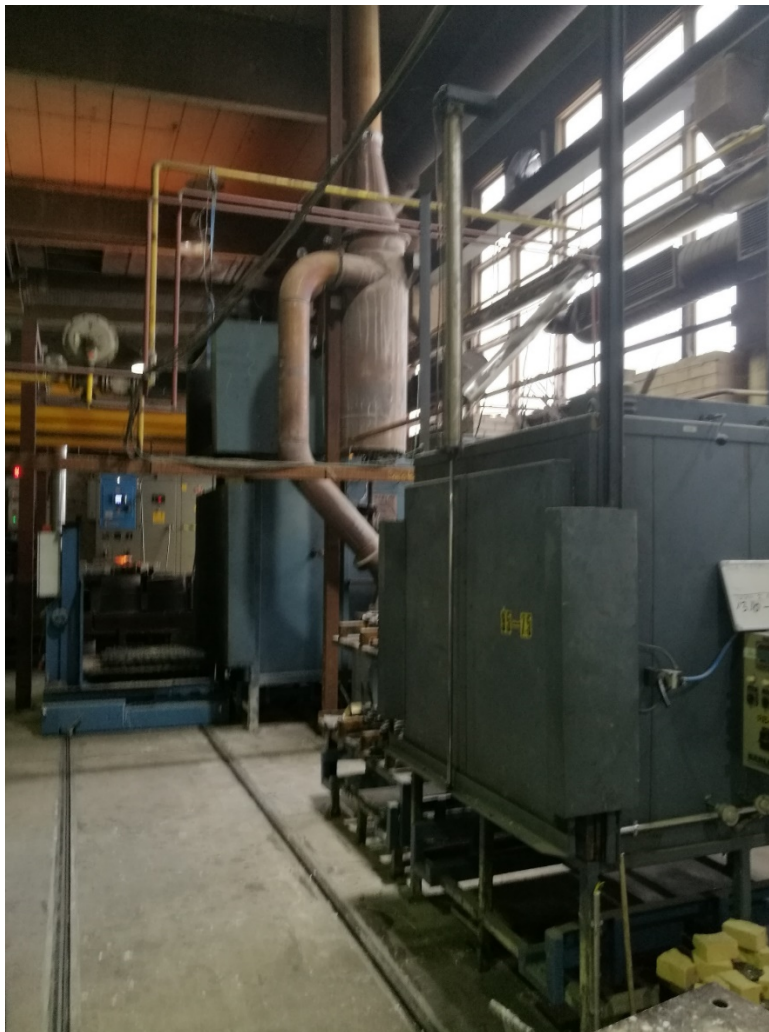
Kuva 9. Polttouunit ja uunitusvaunu radastoineen asennettuina.
