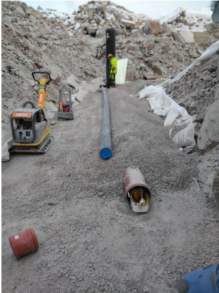
KUVA 11. Vesijohdon sijainti vesihuoltokanaalissa (Pehkonen 2018-04-11)
