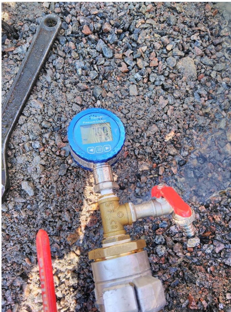
KUVA 13. Äänekosken Energian painemittari (Pehkonen 2018-05-28)
