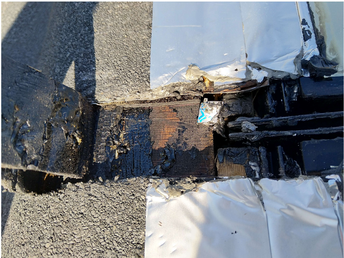
Kuva 2. Vuotovesiä ja kondenssia ei ole johdettu ulos rakenteista
