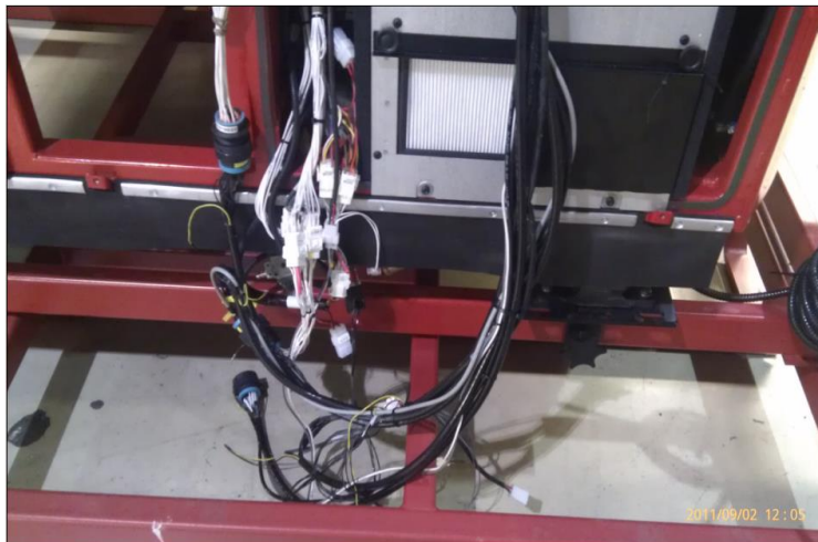
Kuva 13 Ero lattiatilassa, kun johdot ovat tuettu
