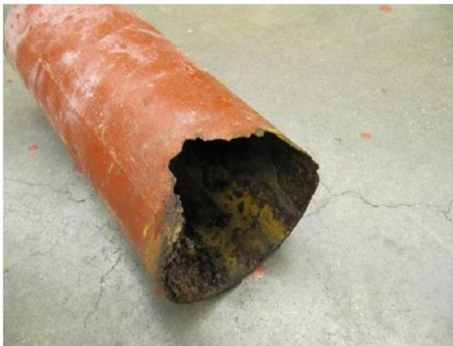
Kuva 14. Puhkisyöpyneet valurautainen viemäriputki [1]
