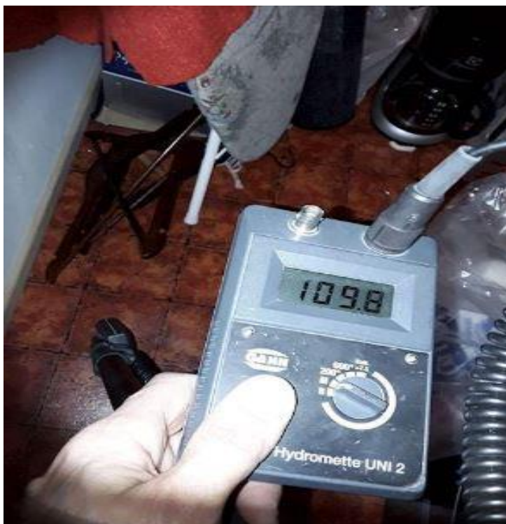
Kuva 8 Vaatehuoneen märkää pintamittaus arvoa (Kokkonen, 2018-18-04)
