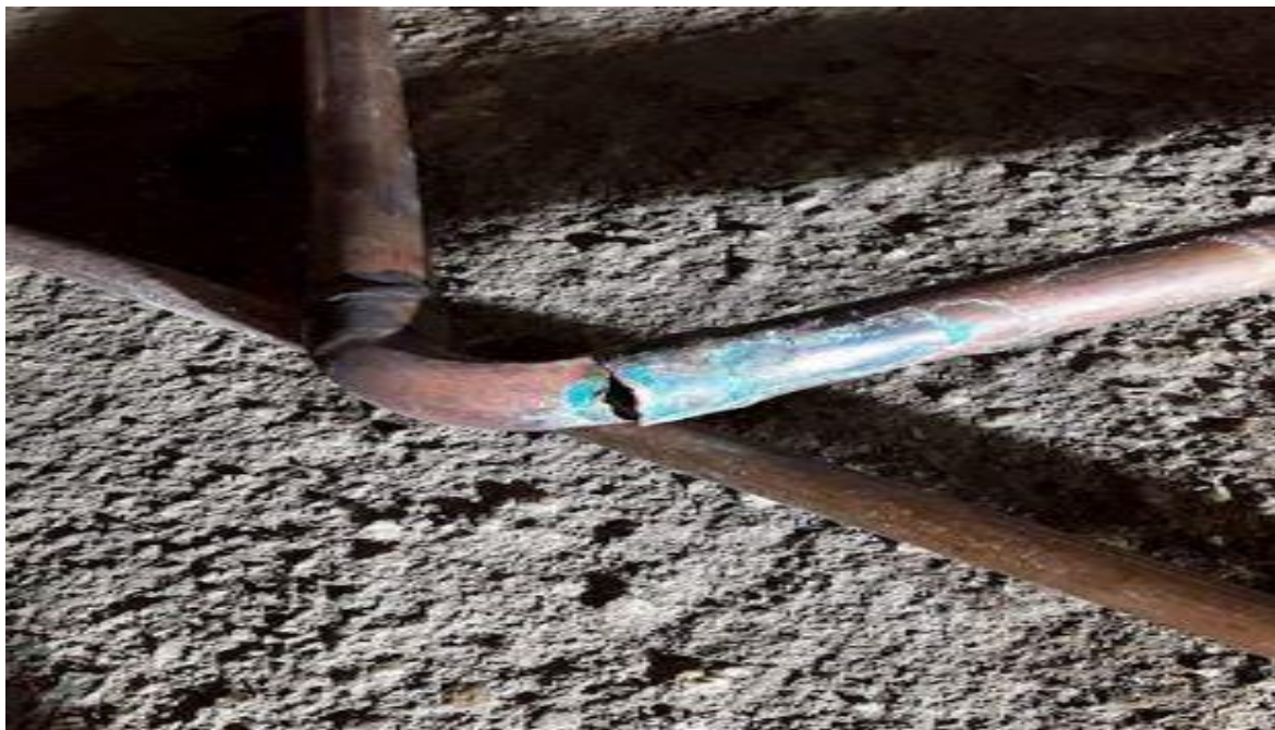
Kuva 3 Vuotanut putki (Kokkonen, 2018-18-04)
