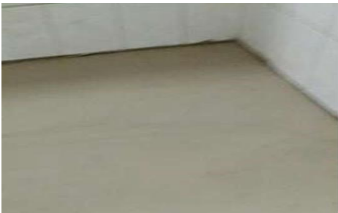
Kuva 18 Wc:n lattiavalu (Kokkonen, 2018-18-06)
