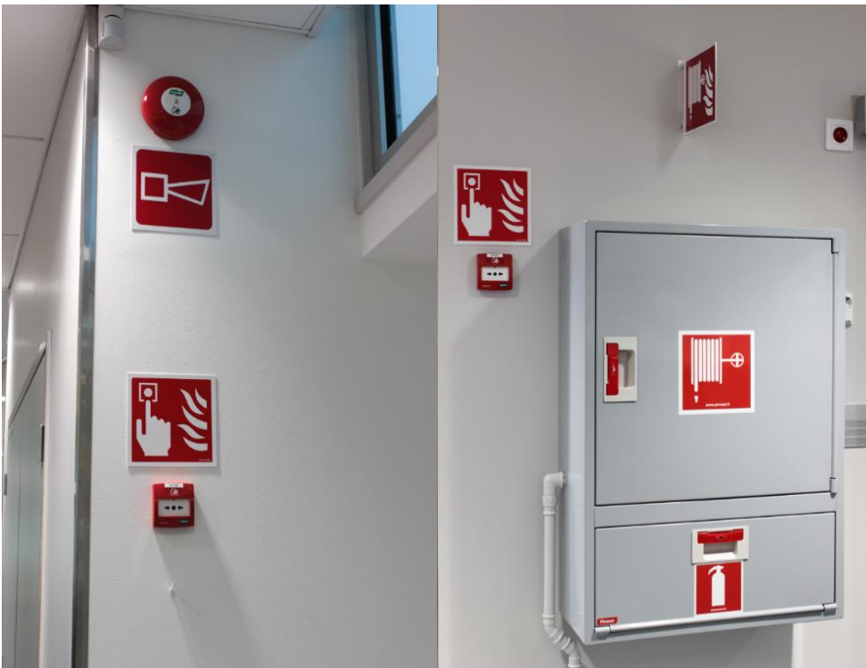
Palohälyttimien ja sammutuslaitteiden sijaintien merkintöjä.
