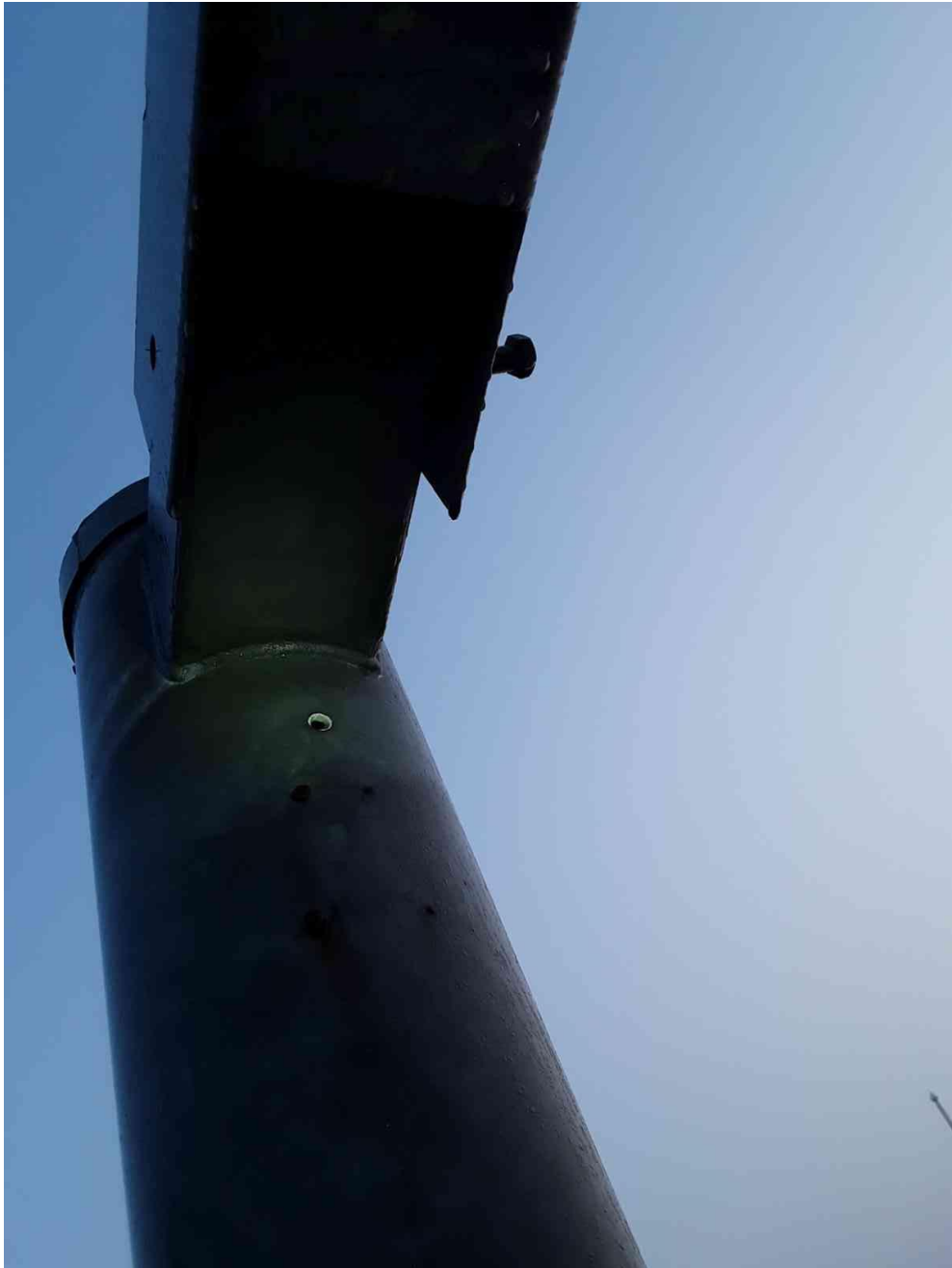
Kuva 12. Mutteri puuttuu, minkä vuoksi pultti on päässyt liikkumaan.
