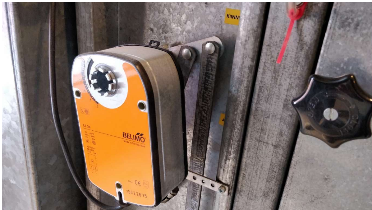
KUVA 2. Ilmanvaihtokoneen pellin toimilaitte Belimo LF24. (Rönkkö 2018)
