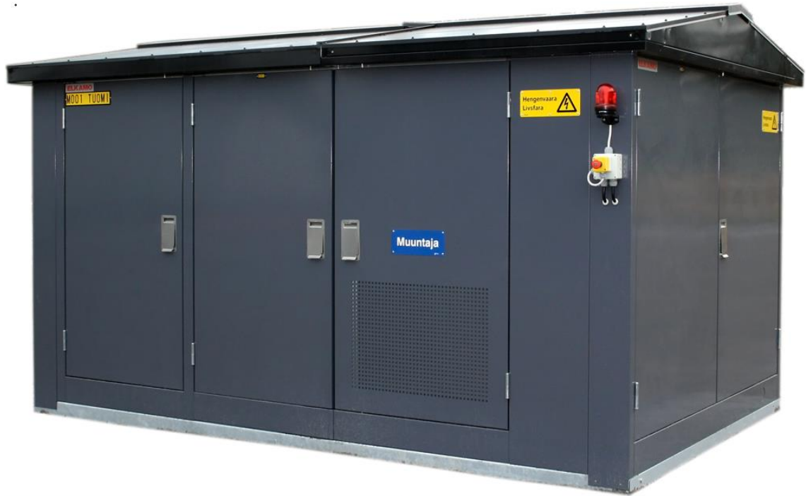
KUVA 4. TAKK:lla oleva TUOMI puistomuuntamo
