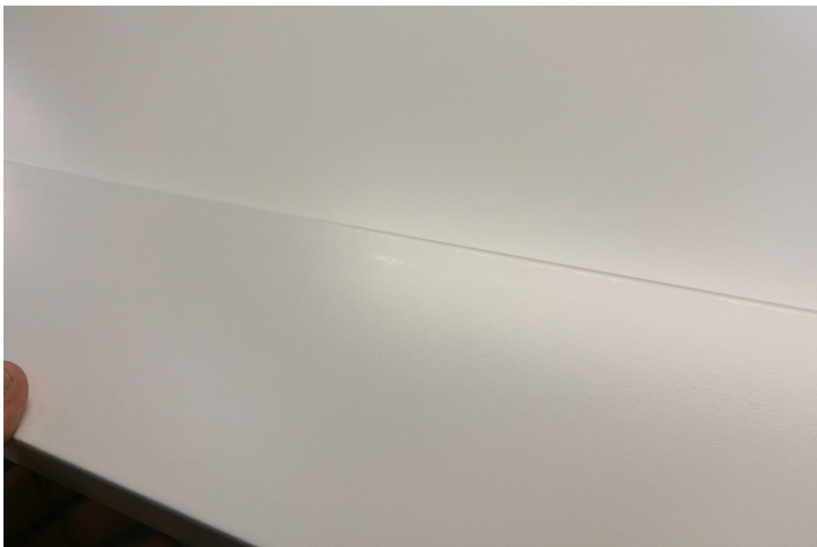
Kuva 4. Vähäisiä kiillottumia valmiissa maalipinnassa
