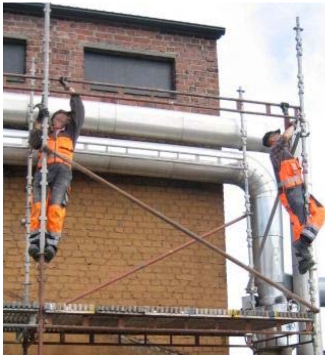
Kuva 33. Kirvesmiehet ovat useimmiten hengenvaarassa asentaessaan telineitä puutteellisin tiedoin ja taidoin.
