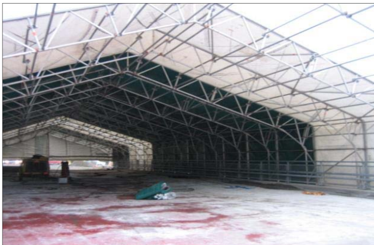
Kuva 36. Sääsuoajakatoksen asennustyöturvallisuusvarusteissa olisi kehittämistä.
