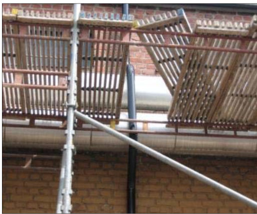
Kuva 34. Syöksytorven asennuksen jälkeen telinetaso on jäänyt korjaamatta.
