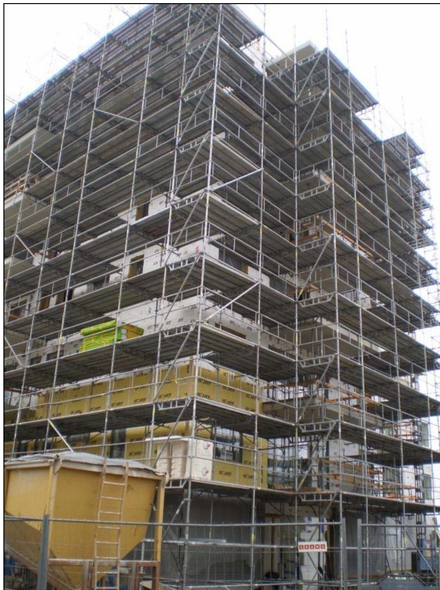
Kuva 3. Moduulijärjestelmäteline konsolilla Joensuun Aittarannassa 2011.
