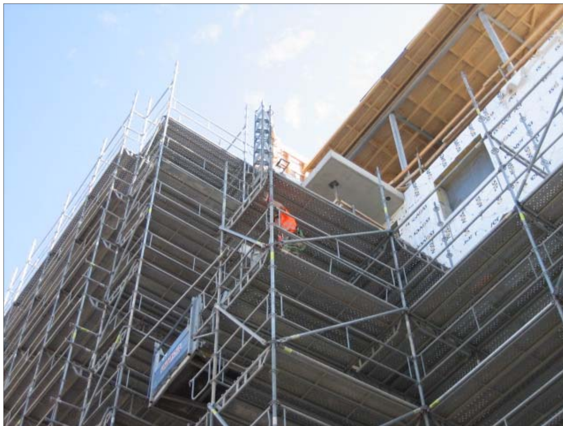
Kuva 6. Telineasentaja käyttämässä tavarahissiä telineosien nostoon. Yhdellä kertaa nousee vain 18 pystysalkoa, joten hissi on kovassa käytössä.
