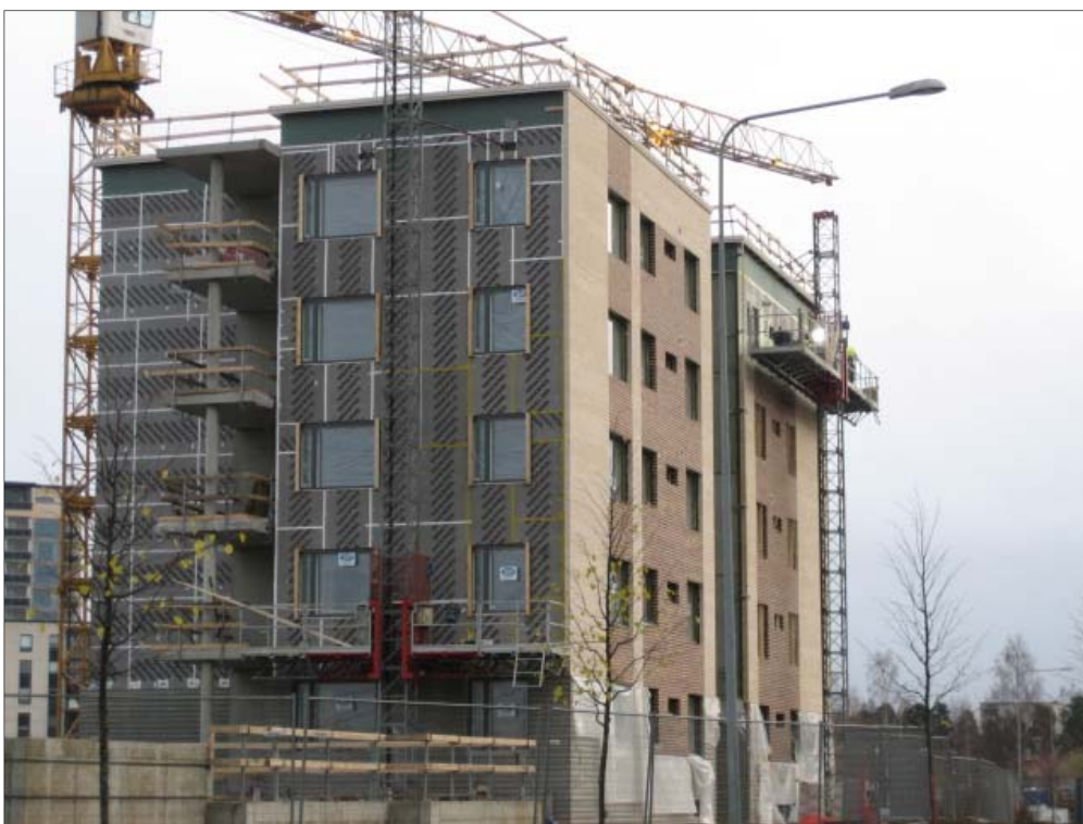
Kuva 21. Kaksi mastolavanostinta muodostaa tehokkaan vaihtomestan.
