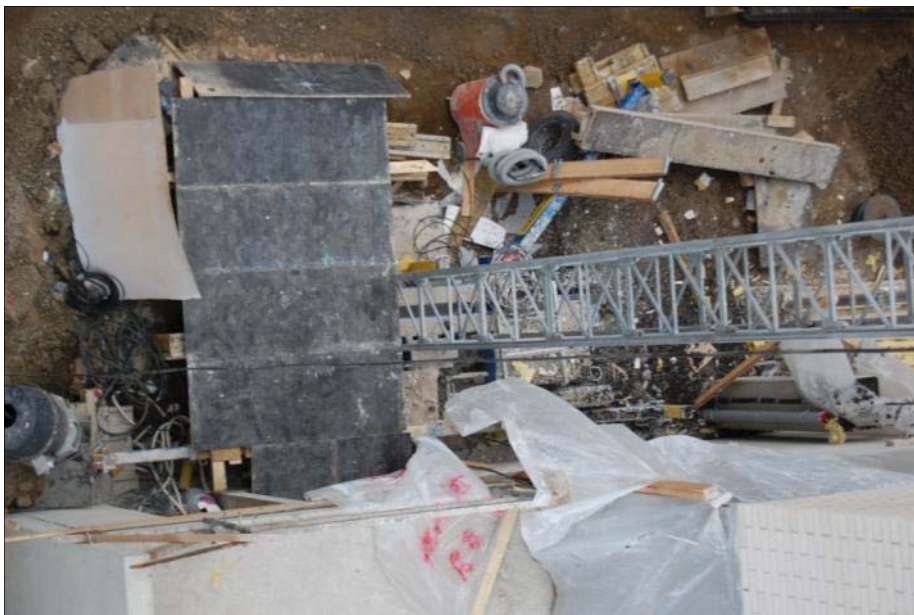
Kuva 31. Hengenvaarallinen kulkutie mastolavanostimen alla.
