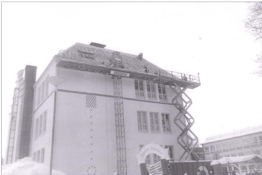
Kuva 16. Kuvan kattoasennustyöhön kapasiteetiltaan liian pieni mastolavanostin vaati rinnalleen saksilavanostimen, että haluttuun lavapituuteen päästiin. (Kuva: Timo Ruotsalainen)
