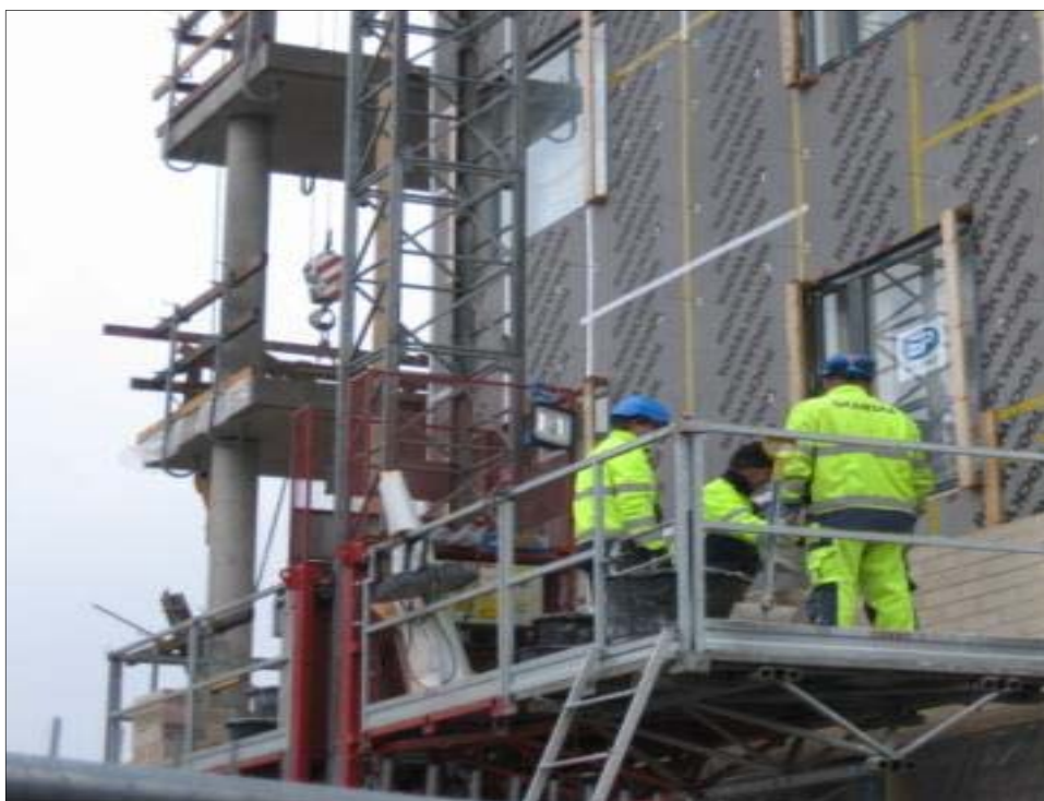
Kuva 23. Mastolava ilman muurauskonsolia ei muodosta tehokasta työalustaa muuraustyöryhmälle.
