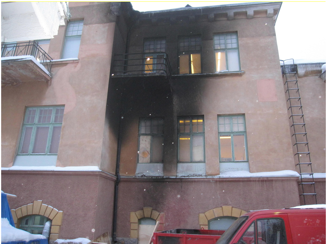
Kuva 7. Lasten päiväkoti Linnunlaulun palanut parveke
