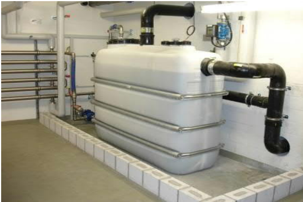
Kuva 20. Finess Oy:n lämmöntalteenottosäiliö [14]
