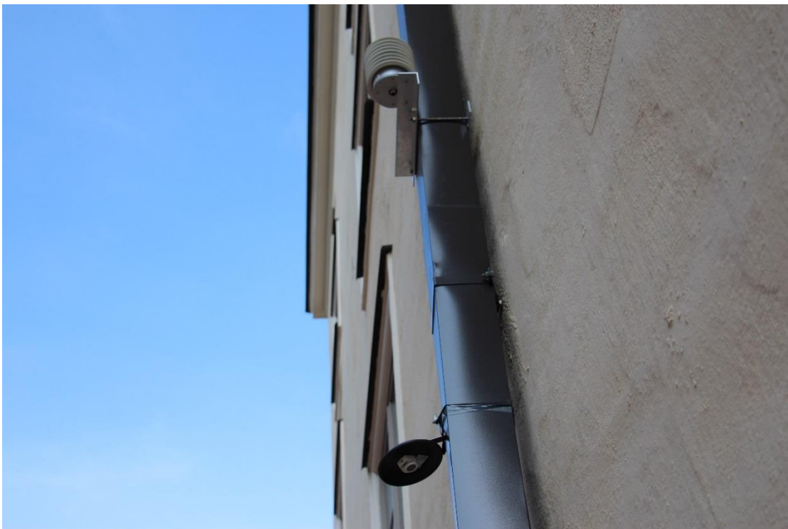
KUVA 5. Sensori I4 ja passiivikeräin 3 Mäkeläntkadun katukuilussa itäpuolella. Kuva: Nelli Kaski/HSY
