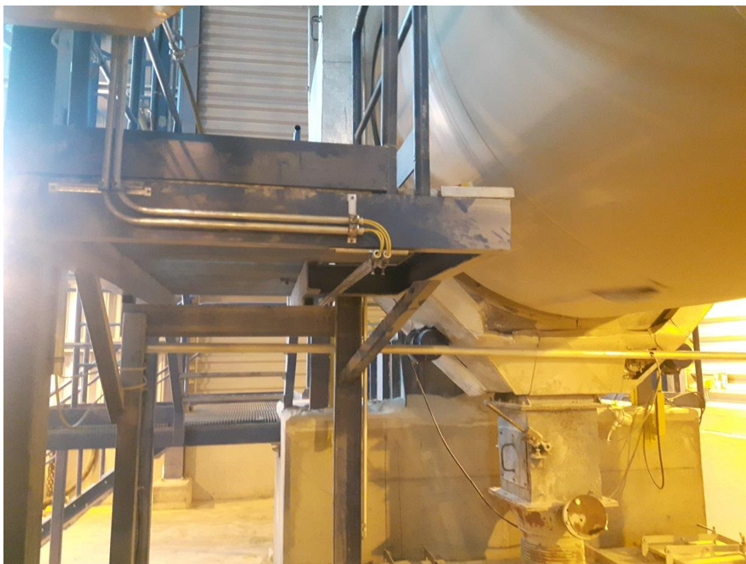
KUVA 61. Mittauskaapelit suojaputkessa (Turunen 2018-03.)
