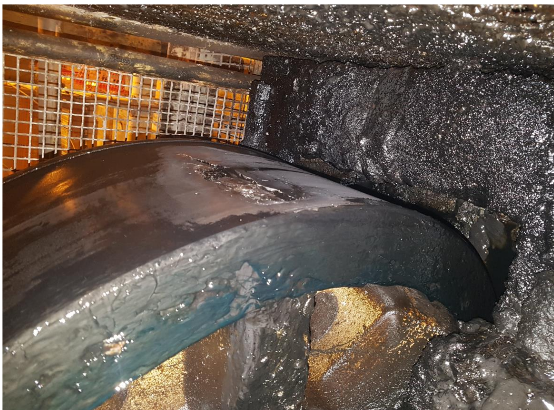
KUVA 47. Rikkoutuneen kantopyörän pinta sivulta (Turunen 2018-05.)
