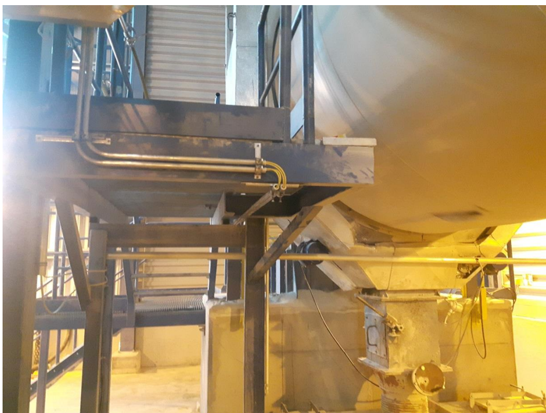
KUVA 60. Mittauskaapelit suojausputkessa (Turunen 2018-03.)
