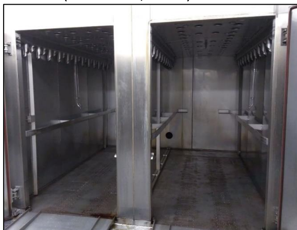
Kuva 3. Autotherm-uunin kypsennyskammiot. Uunin käytävien välissä on väliseinä, joka on alhaalta avoin.
