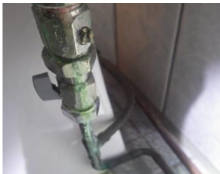
KUVA 5. Putkiliitoksen tihkuvuoto (Asuntokaupan kohteen kuntokartoitusraportti 2018-05-31)
