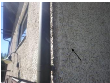
KUVA 6. Rappauksen halkeama (Asuntokaupan kohteen kuntokartoitusraportti 2018-05-31)
