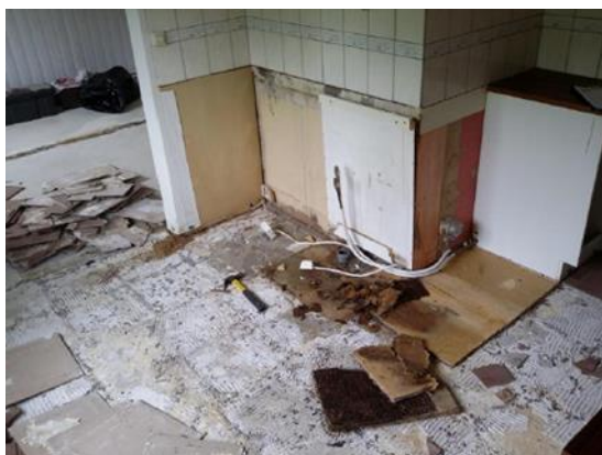
KUVA 7. Keittiön purettu lattialaatoitus (Kohteen kosteuskartoitusraportti 2018-06-25)
