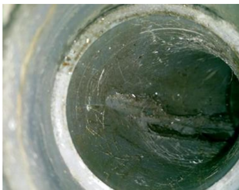
KUVA 12. Vaurioiden aiheuttaja (Kohteen kosteuskartoitus raportti 2018-07-19)
