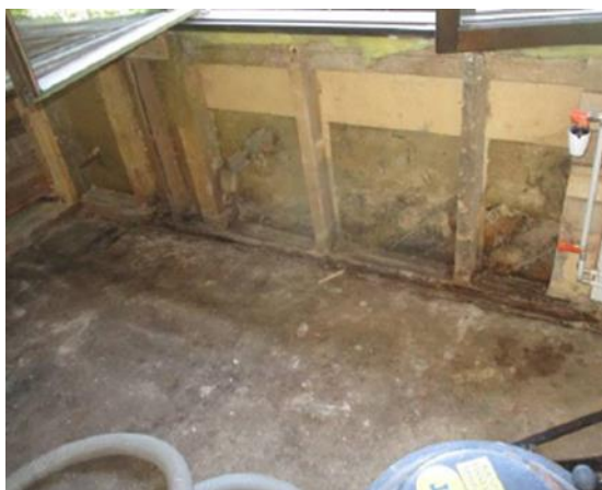
KUVA 15. Keittiön ulkoseinän vaurioitunut puurunko (Harjumäki 2018-07-19)
