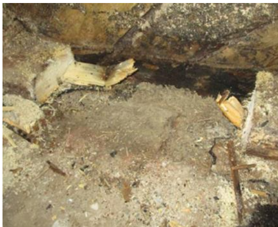
KUVA 16. Ulkoseinän alapuu ja tojalevy vaurioitunut (Harjumäki 2018-07-19)
