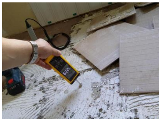
KUVA 10. Kastunut pintabetonilaatta (Kohteen kosteuskartoitusraportti 2018-06-25)
