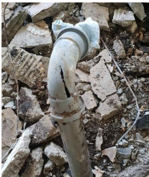
KUVA 13. Reikä muoviputkessa (Kohteen kosteuskartoitus raportti 2018-07-19)
