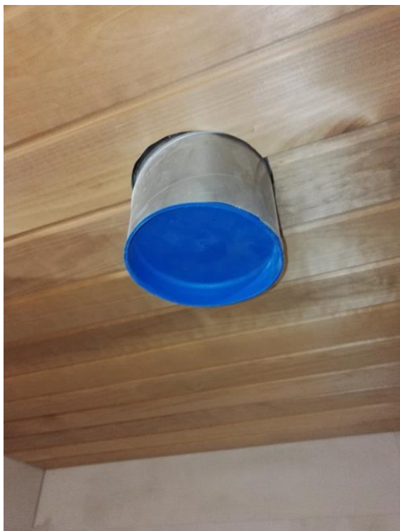
Kuva 8. Ilmanvaihtokanavan pää on tulpattu (Rautiainen 2018)
