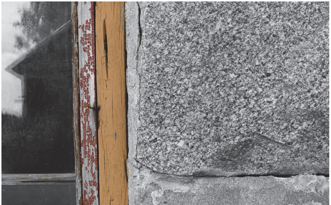
Kuva 70. Navetan pellavaöljymaalilla käsitelty ikkunanpuite. Pellavaöljymaali on aikojen saatossa lähtenyt krakeloitumaan
