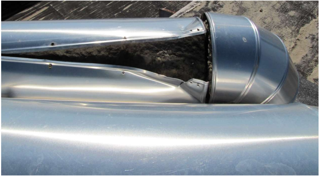
Kuvio 7. Rikkoutunut 4- ja 5-kuivaajan lauhdeputken eriste
